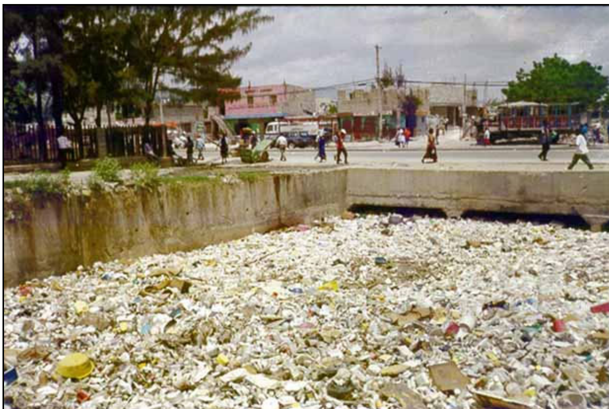
Figure 5 : Accumulation de déchets solides dans le plus grand collecteur d'eaux pluviales urbaines à Port-au-Prince.
